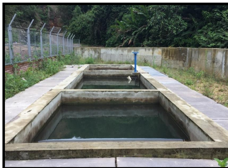
Figura 25 – Desarenador quebrada El Hígado
