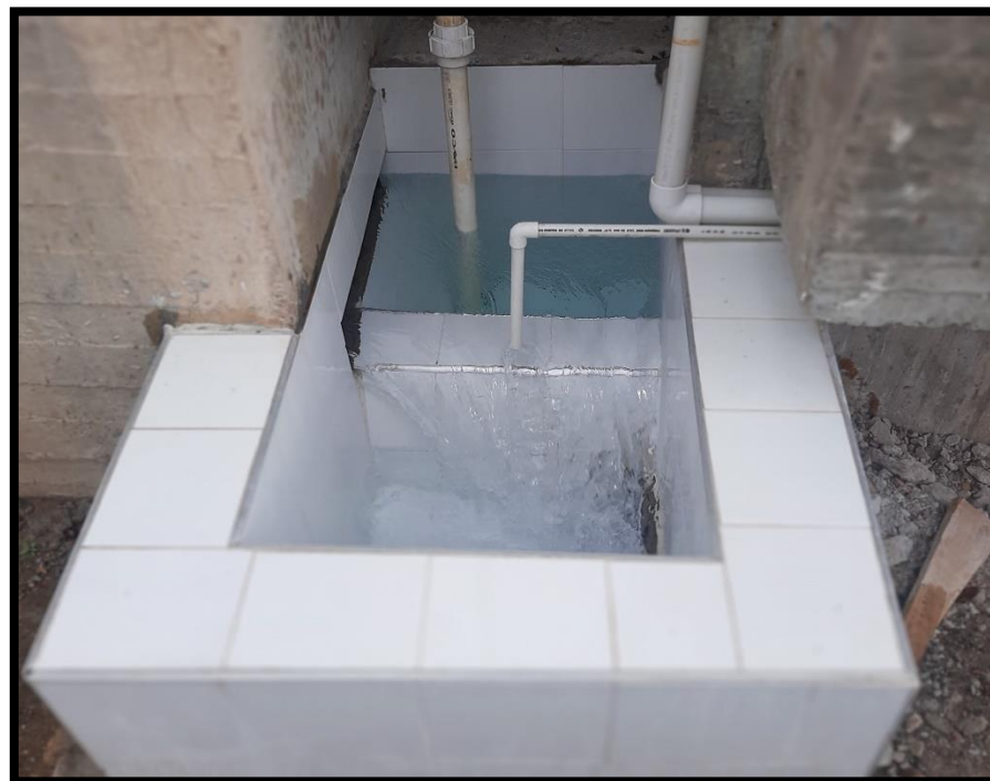
Figura 32 – Tanque de mezcla del cloro gaseoso PTAP Tarqui
