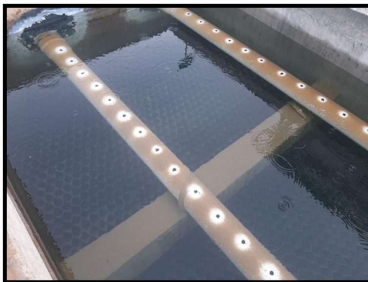
Figura 30 – Vista en detalle del sedimentador de alta tasa tipo colmena en ABS PTAP Tarqui
