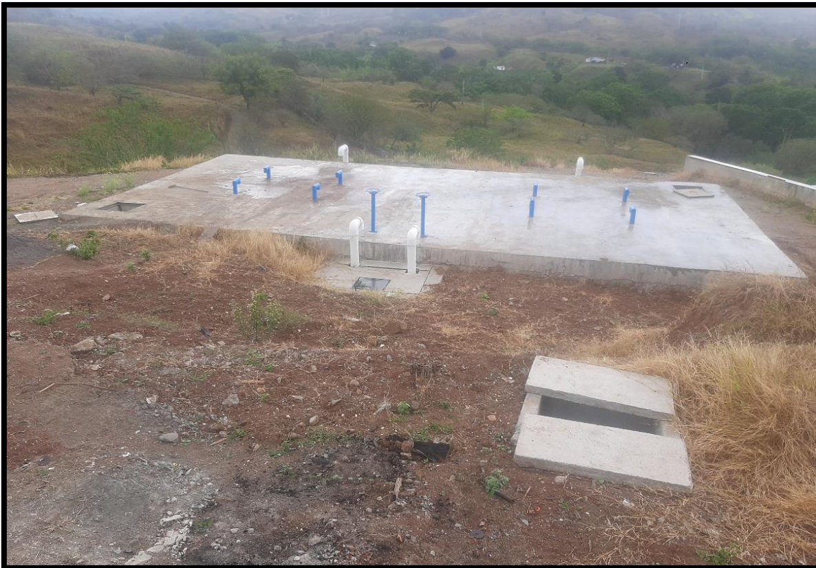
Figura 38 – Tanque de almacenamiento 4 y 5 acueducto del Municipio de Tarqui
