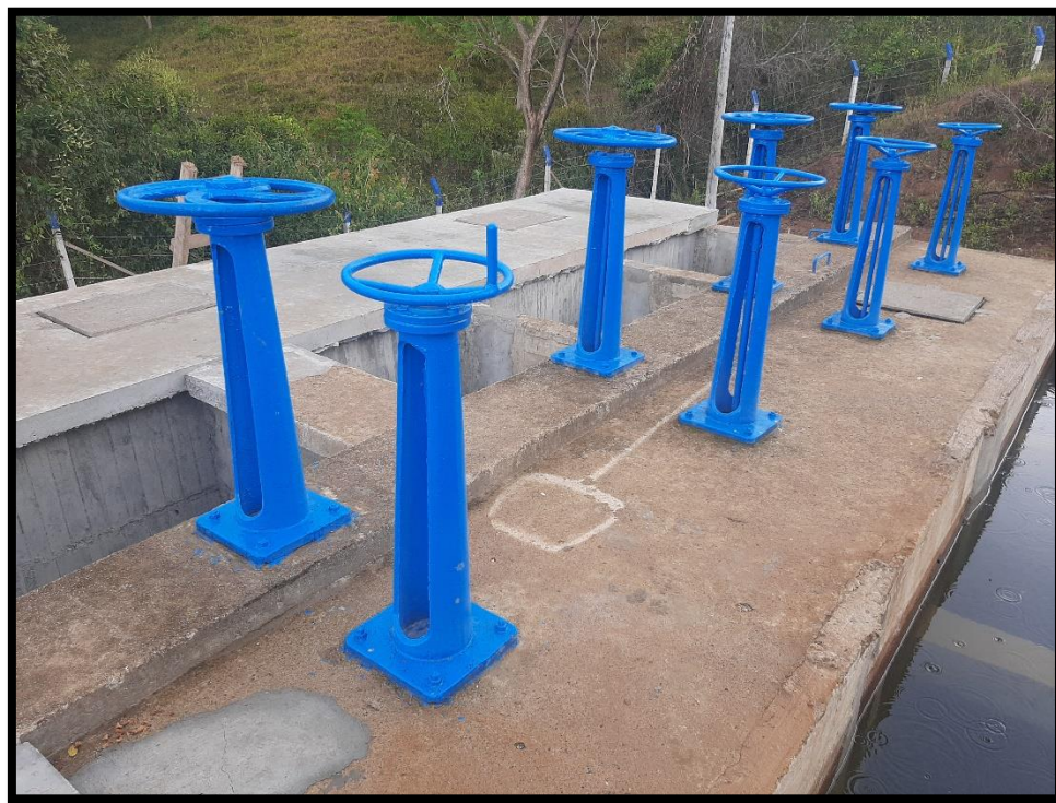
Figura 31 – Conjunto de válvulas de la batería de filtros PTAP Tarqui
