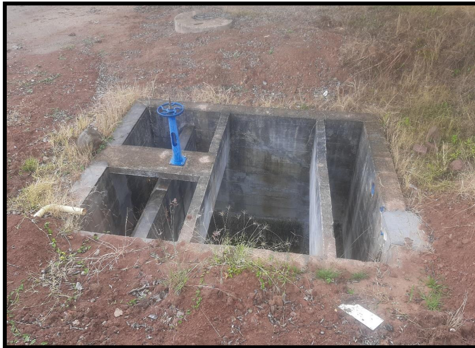
Figura 33 – Espesador gravimétrico de lodos PTAP Tarqui
