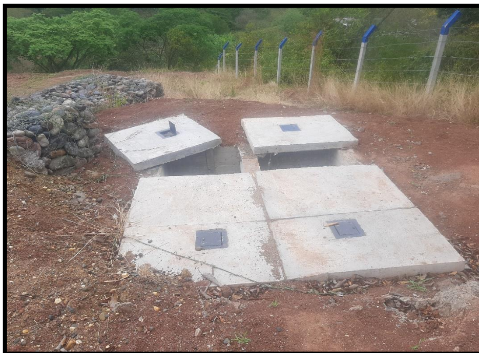
Figura 40 – Estación de macromedición a la salida de la PTAP de Tarqui
