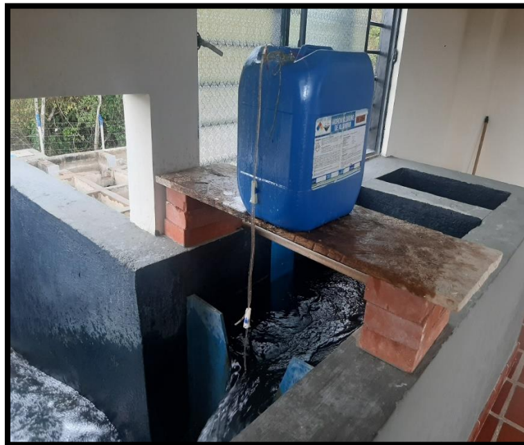
Figura 28 – Vertedero triangular de 45° para medición de caudal y mezcla PTAP Tarqui
