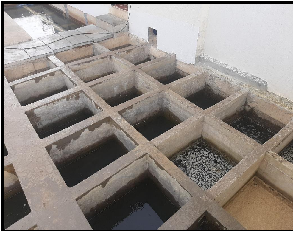
Figura 29 – Vista en detalle de los compartimentos de los floculadores PTAP Tarqui
