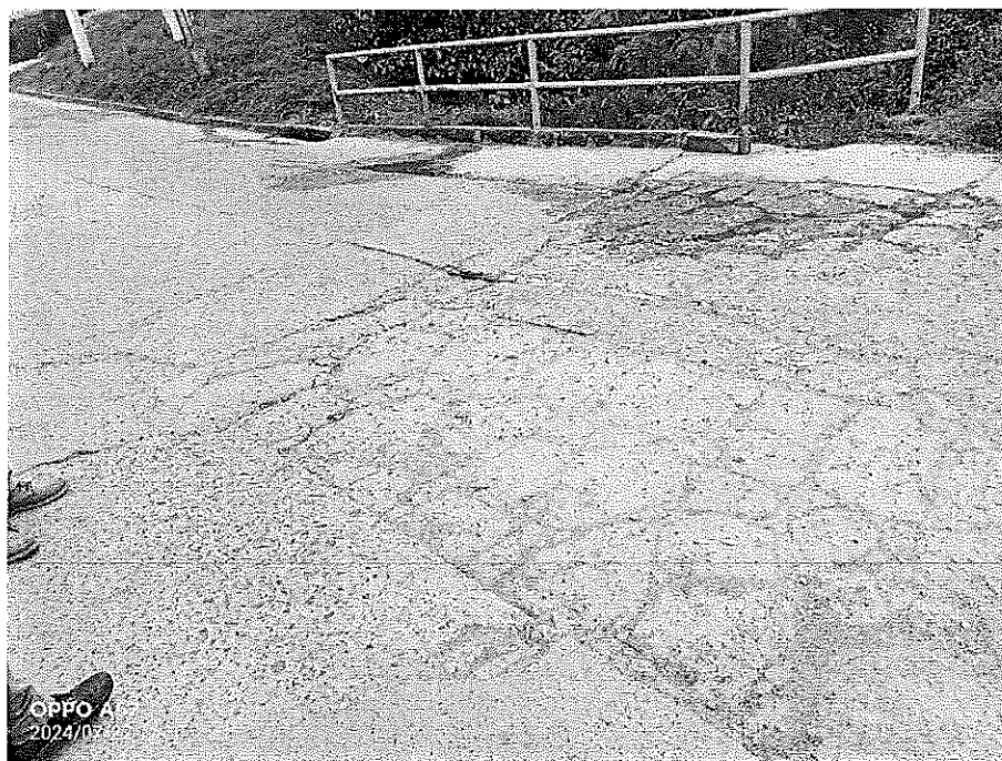
FOTO 18 Y 19 CARRERA 6 No. 5 – 11 Y 19. DESPUES PASO PONTON
